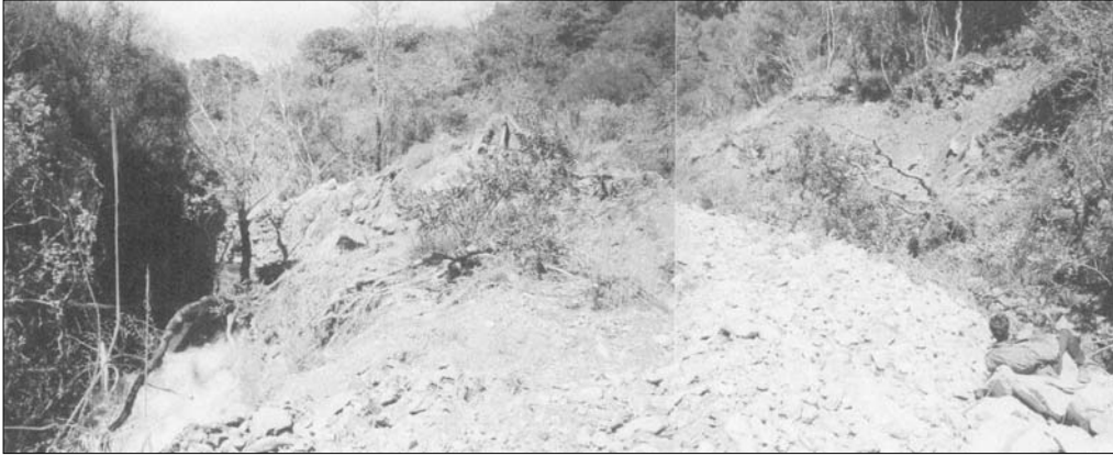
Σχήμα 5. Κάτω όριο (πόδας) κατολίσθησης. Διακρίνεται η ανασηκωμένη κοίτη του ρέματος.
