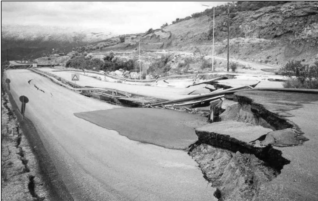
Σχήμα 5. Άποψη του βυθίσματος που προκάλεσε η κατολίσθηση στο οδόστρωμα της Ε.Ο. Κορίνθου-Τρίπολης.
